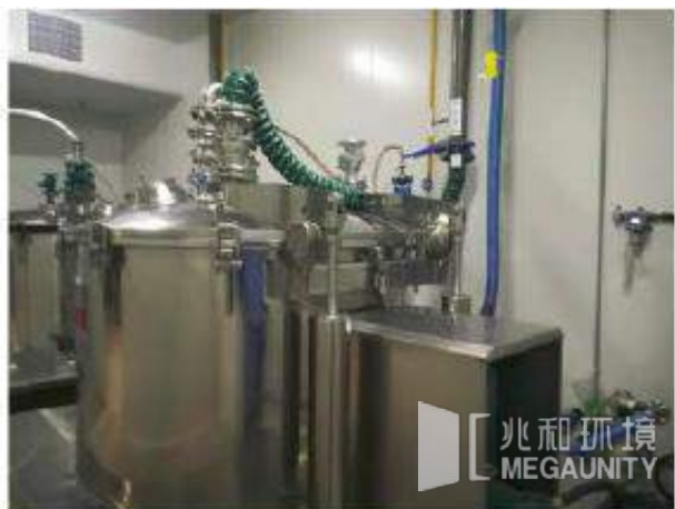
上卸料离心机，采取固定管路转移，密闭放料，独立引风、固定母液转移管线
